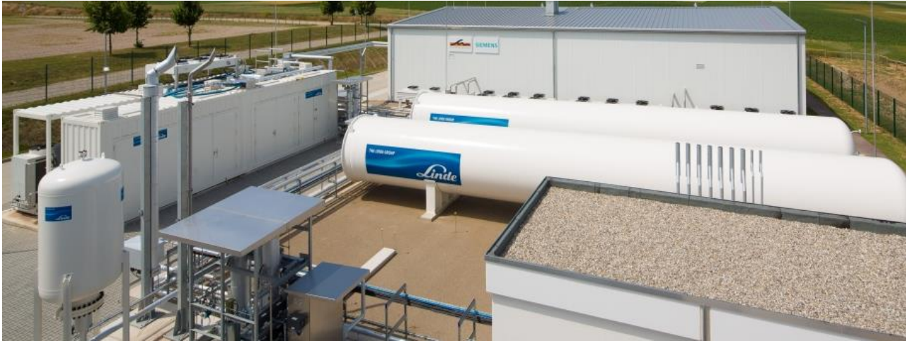
Elektrolyseanlage Energiepark Mainz 1,3 MW - Elektrolyse; Quelle: pv-magazin.de
