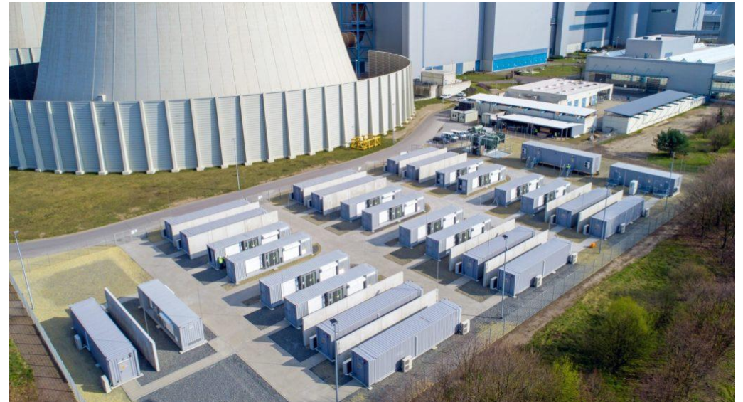
Batteriespeicher „Big Battery“ Schwarze Pumpe, 50 MW Anlage; Quelle: pv-magazin.de
